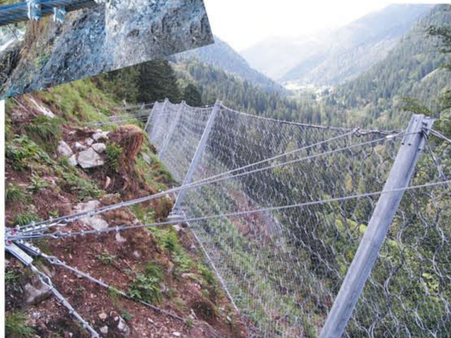
Lavori di esecuzione di barriere paramassi su vari tratti dal km 10+920 al km 11+180 della S.P. N° 31 del Manghen in Loc. Calamento nel comune di Telve Valsugana - TN (Committente Provincia Autonoma di Trento-Servizio Gestione Strade)
