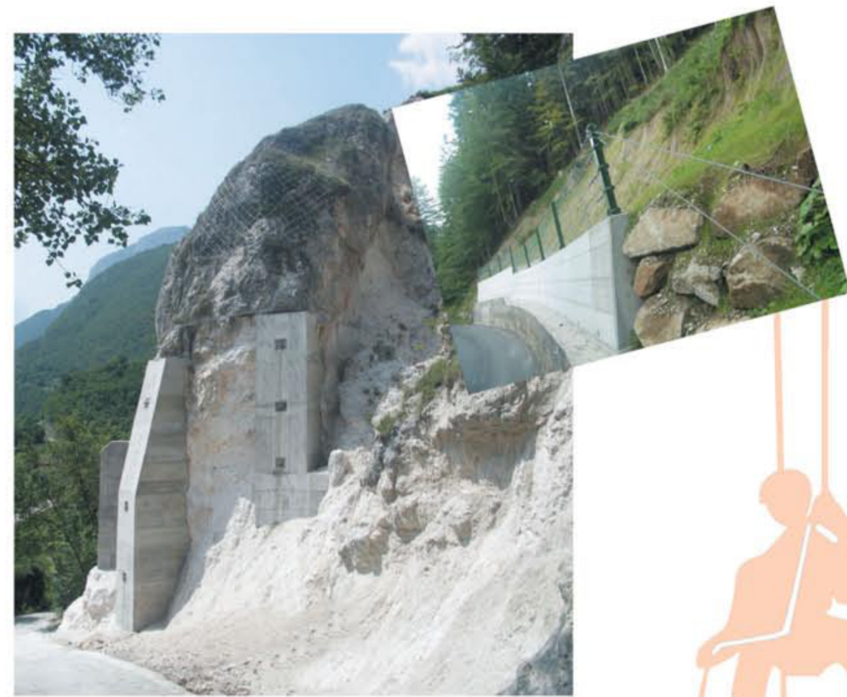
Lavori di consolidamento di somma urgenza di un ammasso roccioso a monte della strada comunale "Via alla Busa" nel Comune di Aldeno - TN (Committente Comune di Aldeno - TN)
