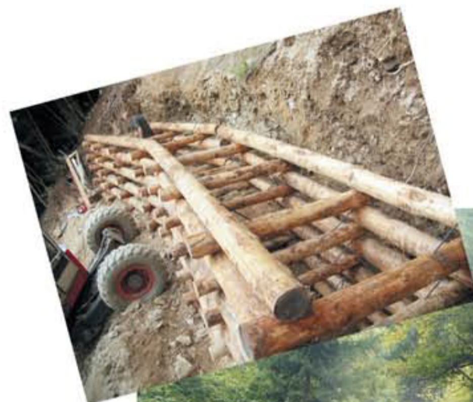
Lavori di messa in opera geostuoia per rinverdimento rinforzato di scarpate sovrastanti la strada comunale per la Frazione di Gresta (Committente Comune di Segonzano - TN)
